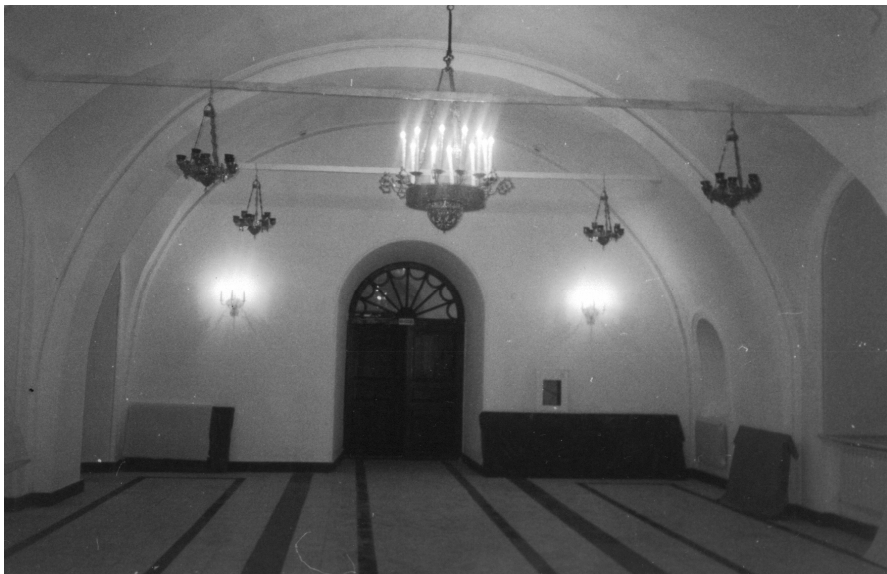
Рис.3 Богоявленский собор в г. Томске. Придел Богоявления Господня. 1-ый ярус. Перекрытие – цилиндрический свод. Справа – распалубка над окном. На первом плане металлические затяжки выше уровня пят свода.
